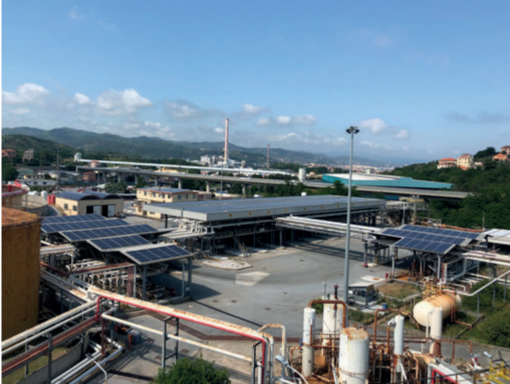
Impianto fotovoltaico realizzato da SolarEdge sullo stabilimento Alkion Terminal di Vado Ligure.
