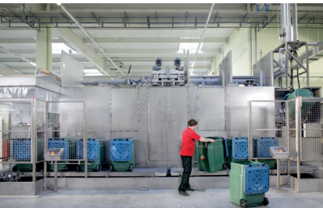
Per i circa 8,4 milioni di panni e i 1.800 zerbini che vengono lavati ogni mese esistono due impianti di lavaggio speciali.
